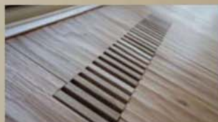
②床下空調システム
